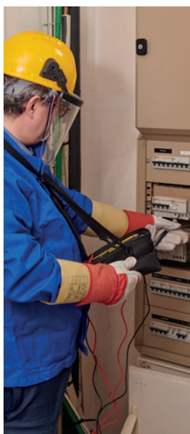
Controllo di un armadio elettrico
